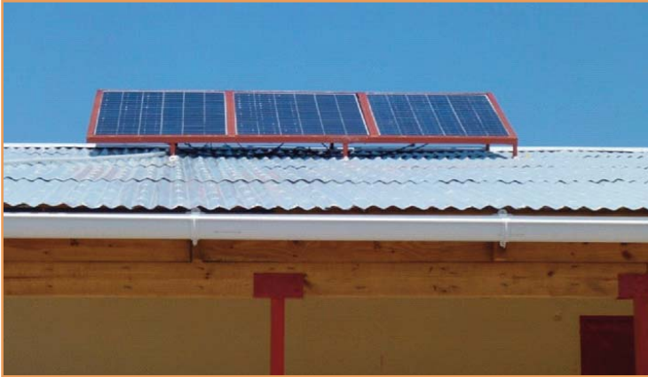
Pannelli fotovoltaici nella scuola Les Abeilles d'Aspam
