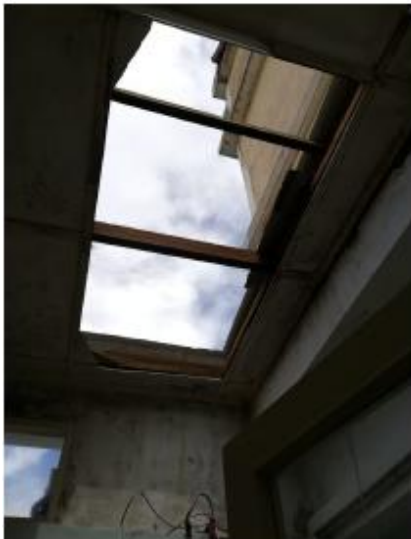
Tetto danneggiato dell'ospedale di Beira
