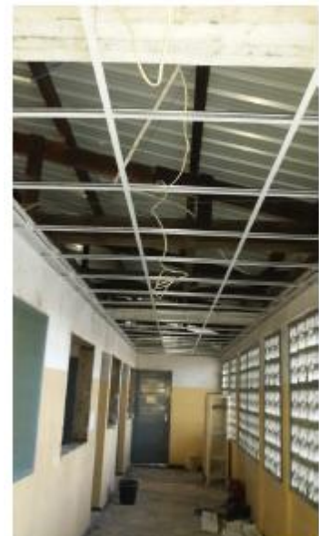
Centro sanitario periferico danneggiato
